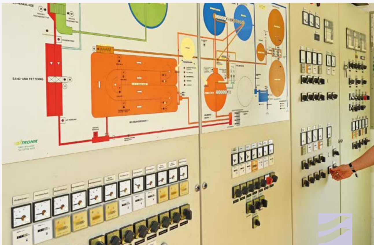
Schaltzentrale Hier werden alle Einstellungen der Kläranlage kontrolliert
