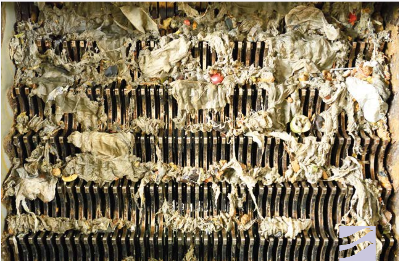
Rechenanlage Erste Reinigungsstufe als mechanischer Vorgang
