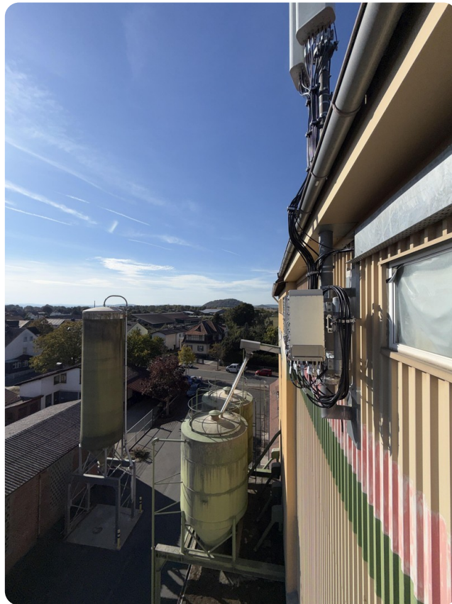
Mobilfunkantennen d. Mieters
